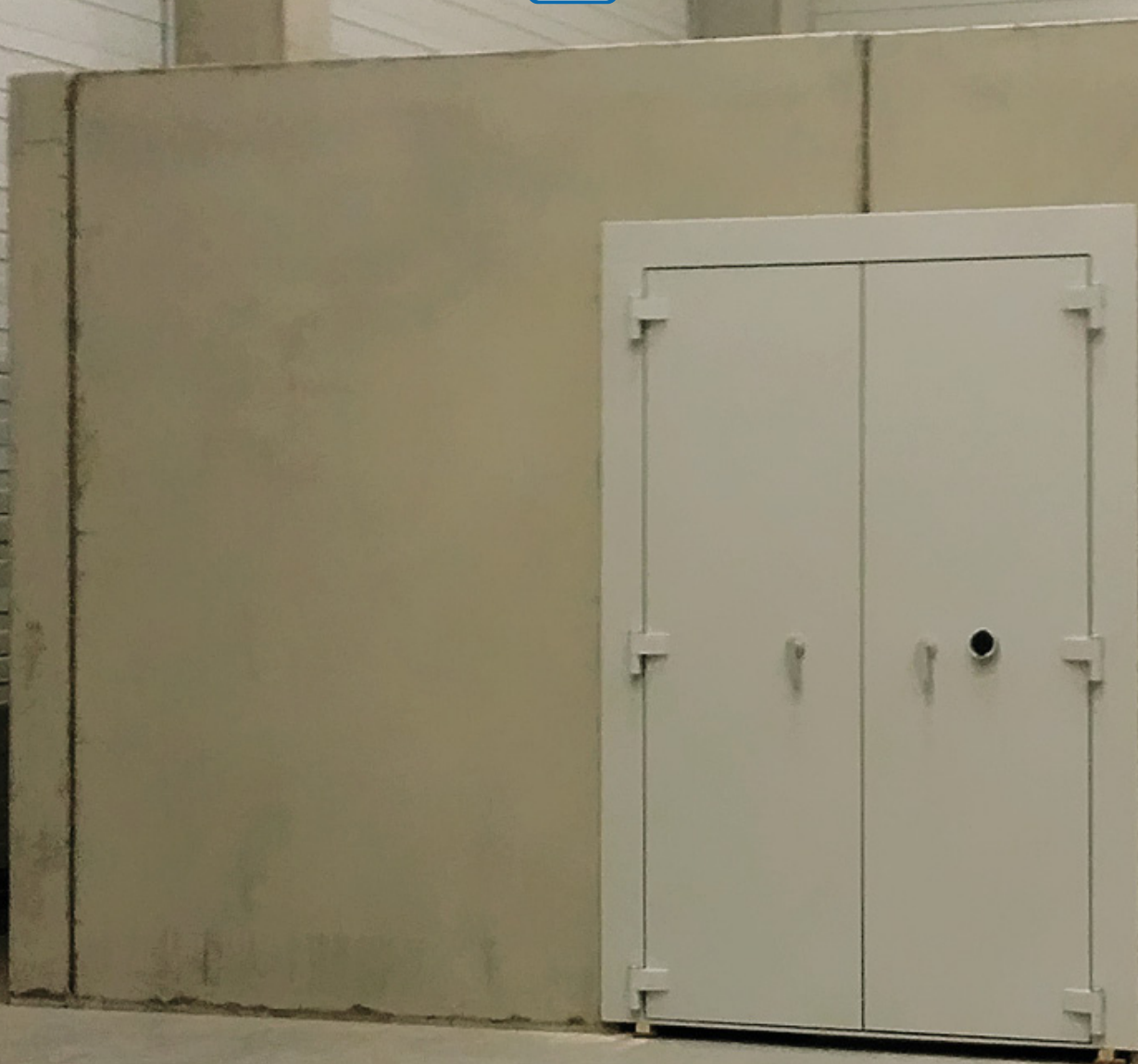
Abbildung: Tresorraumtür im Sonderbau für massiven BTM-Wertschutzraum
